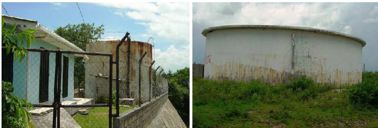
FOTOGRAFÍA 5: REQUERIMIENTOS DE MANTENIMIENTO DE TANQUES DE ALMACENAMIENTO DE AGUA
