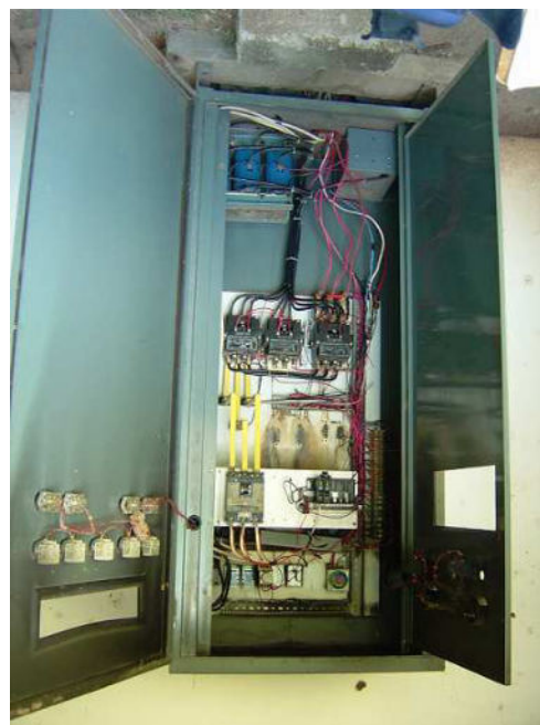
FOTOGRAFÍA 3: PANEL DE CONTROL ELÉCTRICO DE ESTACIÓN DE BOMBEO
