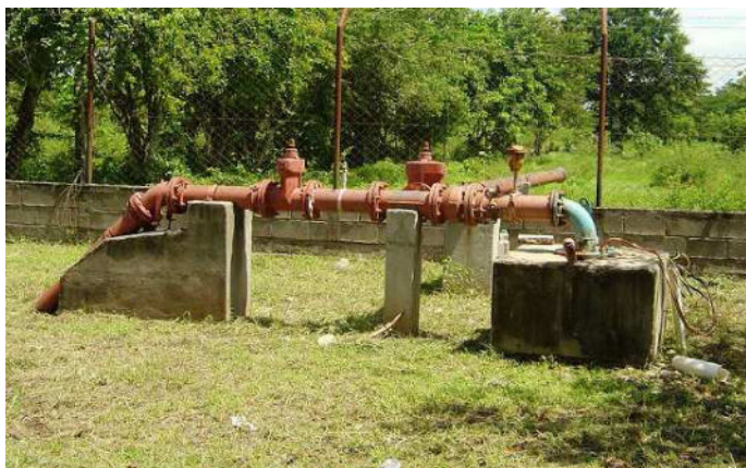
FOTOGRAFÍA 2: FONTANERÍA DE BOMBAS DE POZOS PARA AGUA POTABLE
